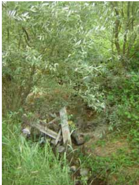
Foto 8. Cisterna- Briglia in legname parzialmente collassata
