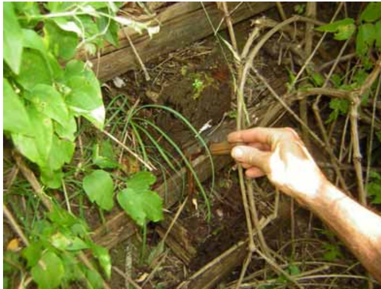
Foto 6. Diano- Palificata in Pino laricio: il coltello penetra completamente nel palo senza sforzo.
