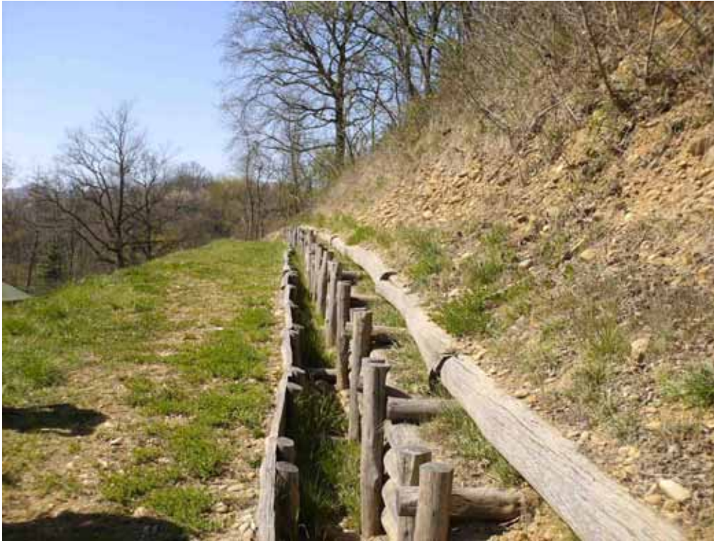
Canaletta di raccolta acque ed opera di contenimento
