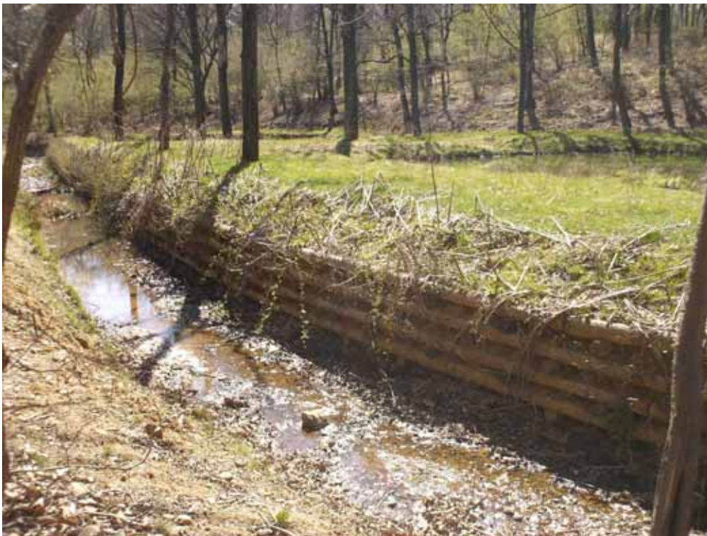
Palificata doppia di arginatura di lago artificiale. Opera eseguita con appalto esterno
